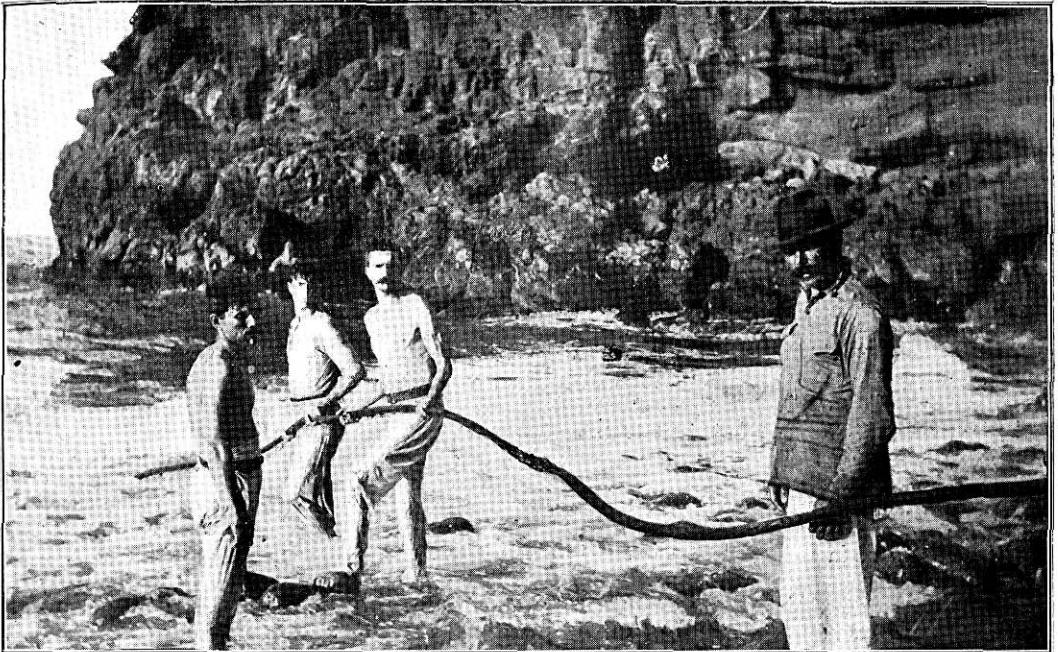
Reparación del cable Tenerife-La Palma. En el centro del grabado puede observarse la avería.
