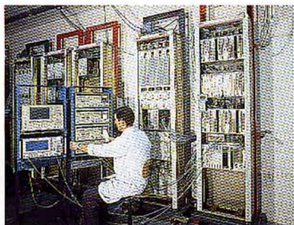
Foto A - Estación terminal, SDH 155 Mbit/s, 128 QAM, 3+1
