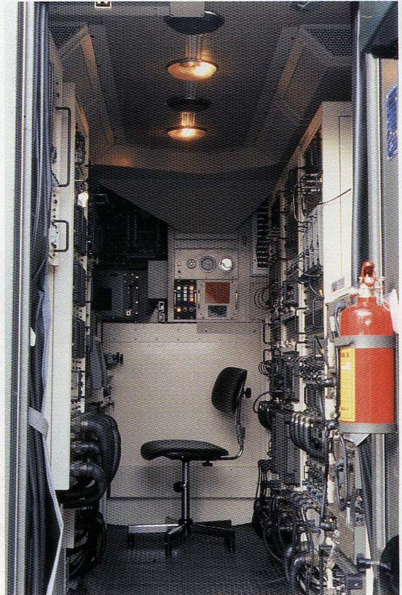
A101 SCRA – PAR instalado en una caseta VEO tipo 1.
