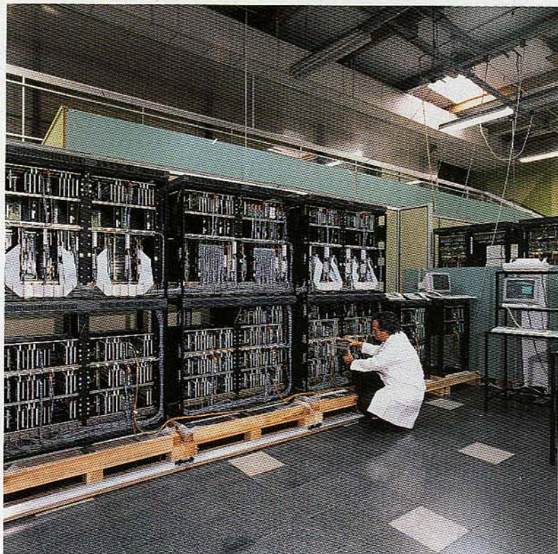
Pruebas de integración de centrales en fábrica.
