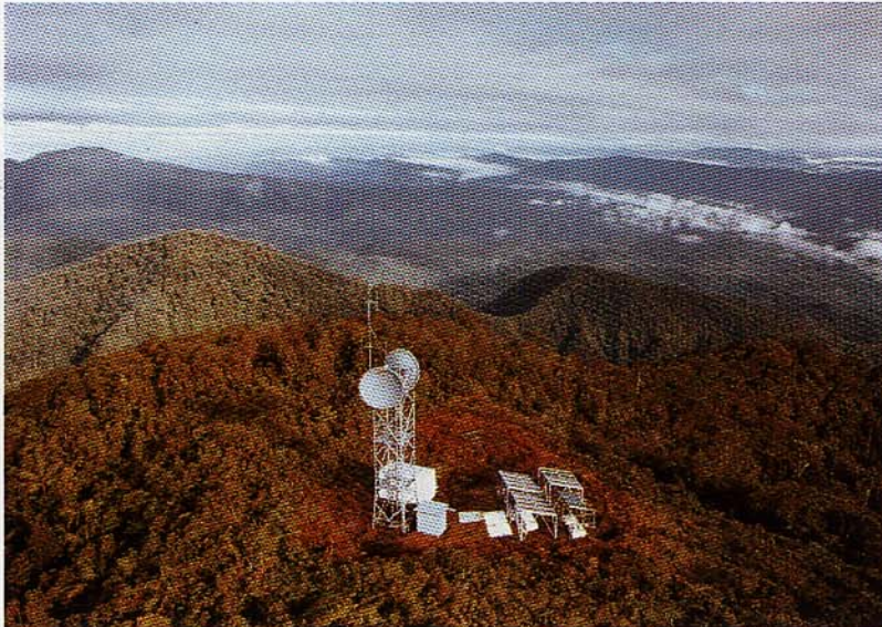
Estación retransmisora de microondas.
