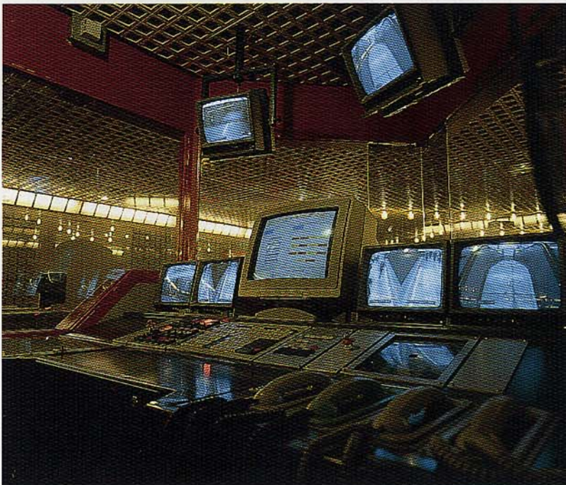
Sala de control de estación maestra para la nueva línea de metro de Milán.
