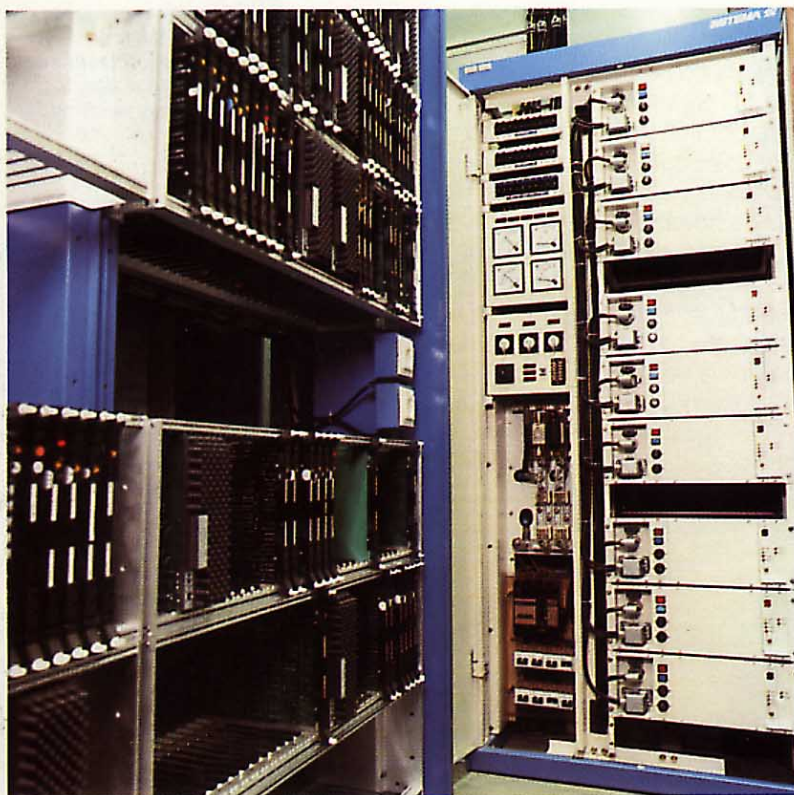
Planta de energía modular integrada en un bastidor del Sistema 12.
