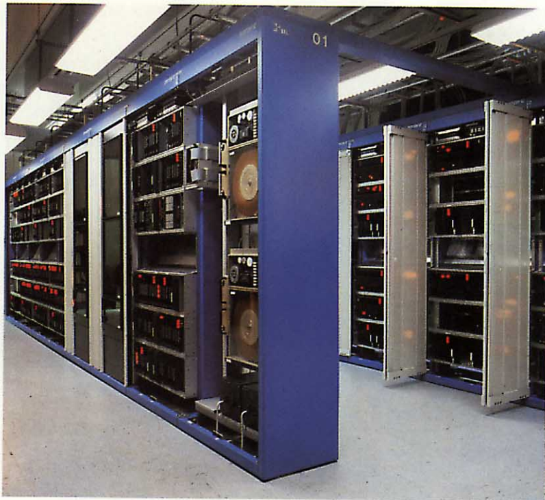
Gran central local Sistema 12 instalada en Wuppertal para el Deutsche Bundespost.
