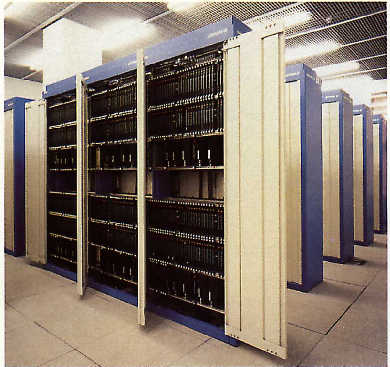
Equipos de la central Sistema 12 de 10.000 líneas en Salamanca, España.
