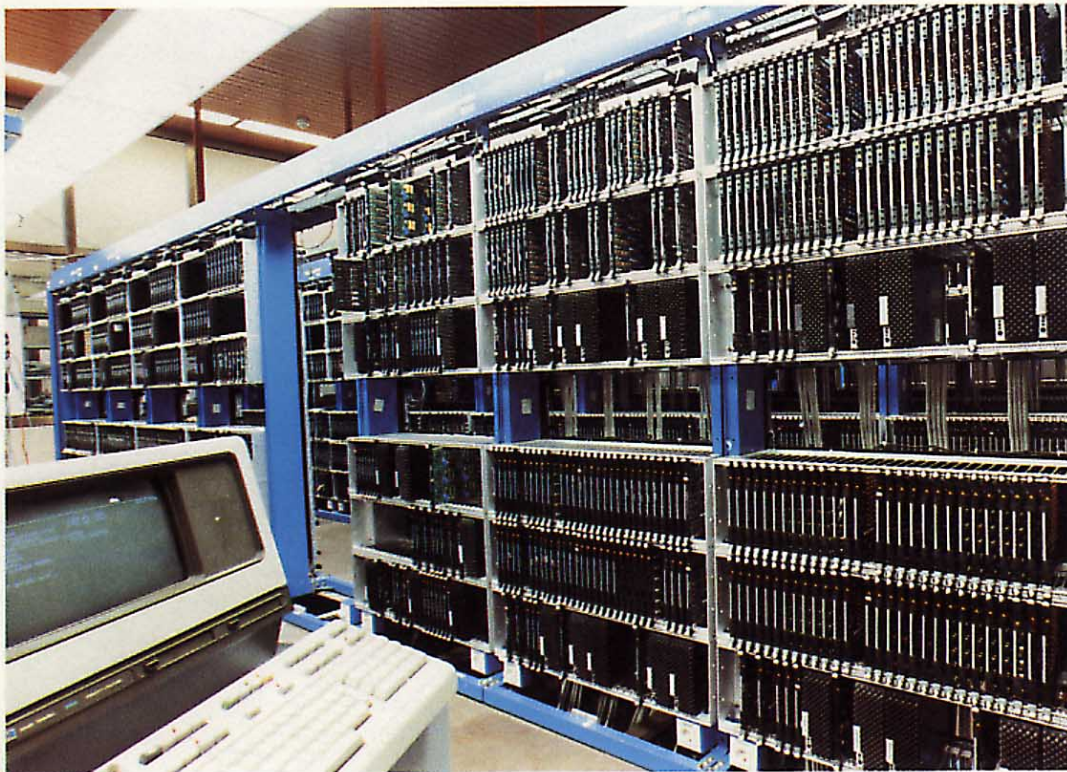
Sala de la central digital Sistema 12 en Acilia.
