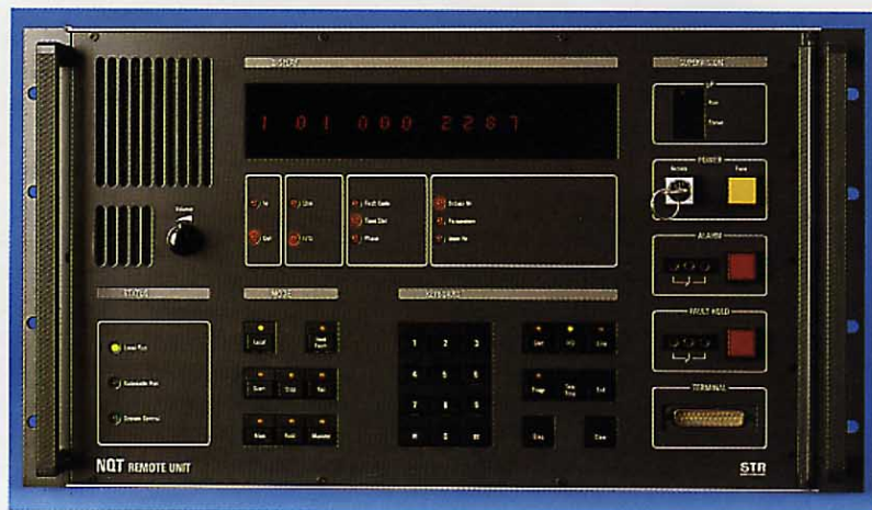
Panel de operación de unidad ejecutora instalada en central.
