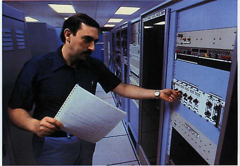
Equipo utilizado para el UDTS, un servicio internacional de comunicaciones de datos por conmutación de paquetes.
