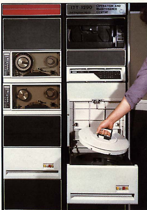
Equipo de operación y mantenimiento del ITT 1240.
