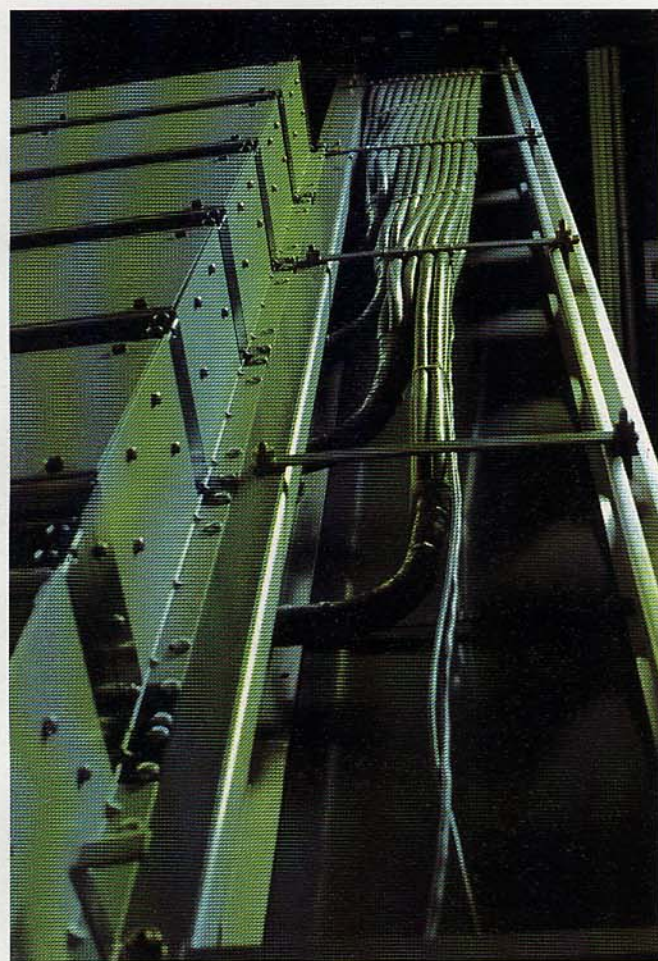
Vista parcial de una instalación de equipo automático de medidas de datos para tráfico y mantenimiento.
