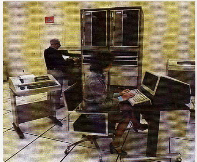
Centro de recogida y procesado de datos en una instalación Autrax. Este sistema está instalado actualmente en la red de CTNE en España.
