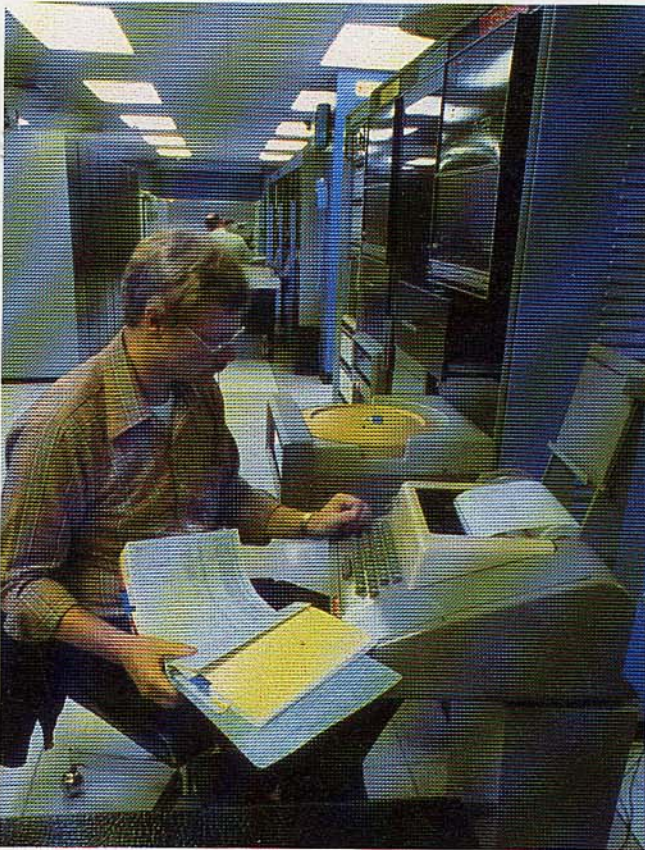
El personal de operación vigila periódicamente el estado del sistema de la central automática de retransmisión (ARX) para asegurar el mantenimiento del elevado grado de servicio que proporciona el sistema.
